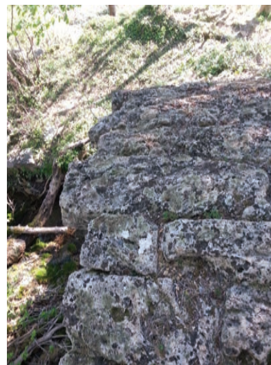
88. Odstupanja u krajevima krova do zapada – Departures in the regularity of roof edges to the west Abweichungen der Dachkanten nach Westen
